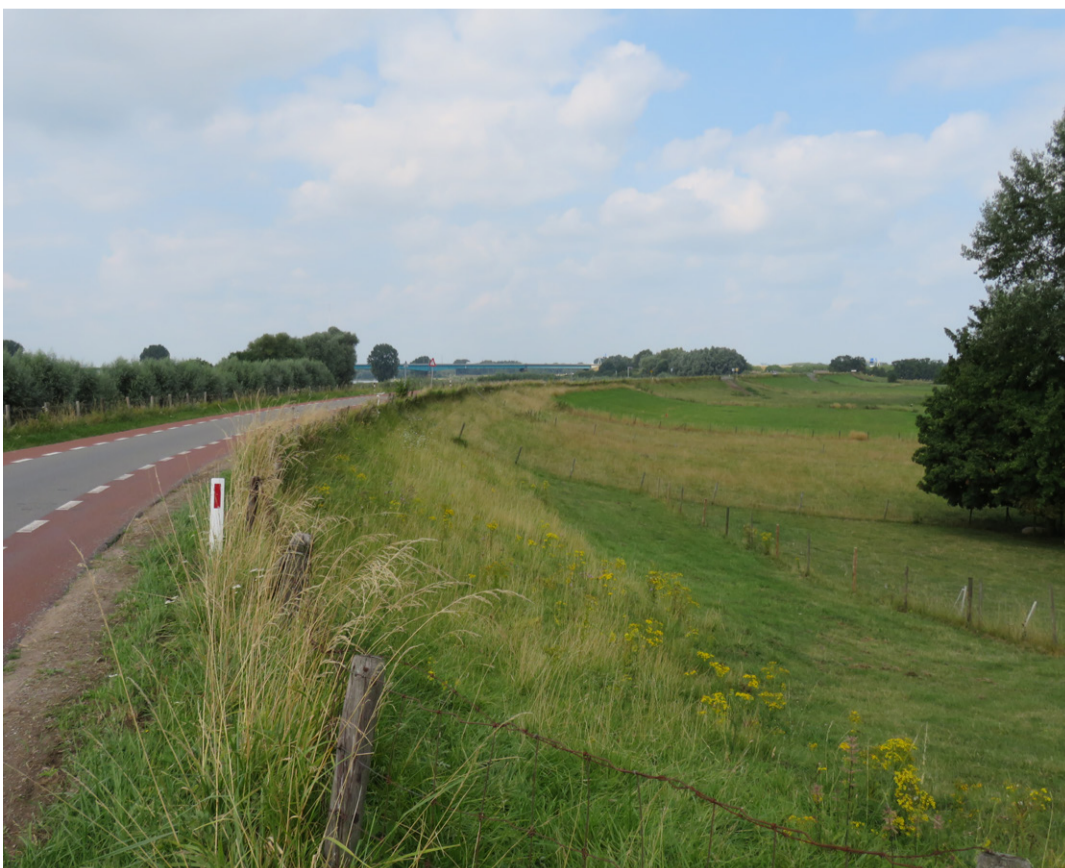
Uitgezakt dijklichaam en berm creëren een hol dijkprofiel waarbij scherpe lijnen vervagen
